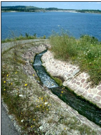
Bild 14 Einlaufbauwerk des Petschbaches (Blick nach Norden auf die Halde Klobikau, links im Bild, und den Lauchstädter Strandbereich, Aufnahme: 26.7.2011, vgl. Zeittafel Sanierung, Bild 5, Seite 154)
