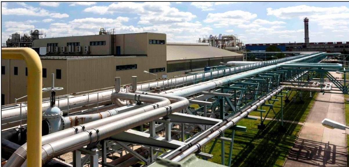
Bild 4 Ein 20 km langes Rohrleitungsnetz verbindet die einzelnen Chemiebetriebe
