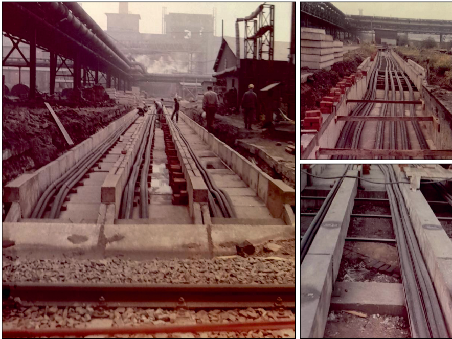
Bild 8a-c Die offen verlegten Kabel (Kabellegung im Kanal Straße 3 von den Freileitungsmasten zur 110 kV-Hauptschaltanlage I 16, Mitte der 1980er Jahre, vgl. Bilder 4a+b)
