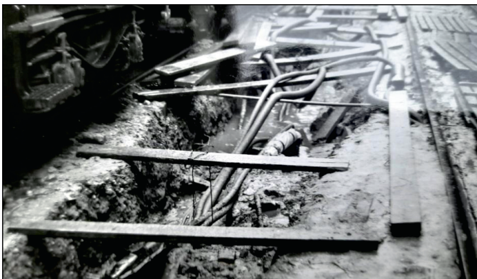
Bild 6 Offene Kabeltrassen im Buna-Werk Schkopau (Kabelreparatur oder Vorbereitung für eine Kabelnachlegung in einer Längsstraße zwischen Gleisanlagen)
