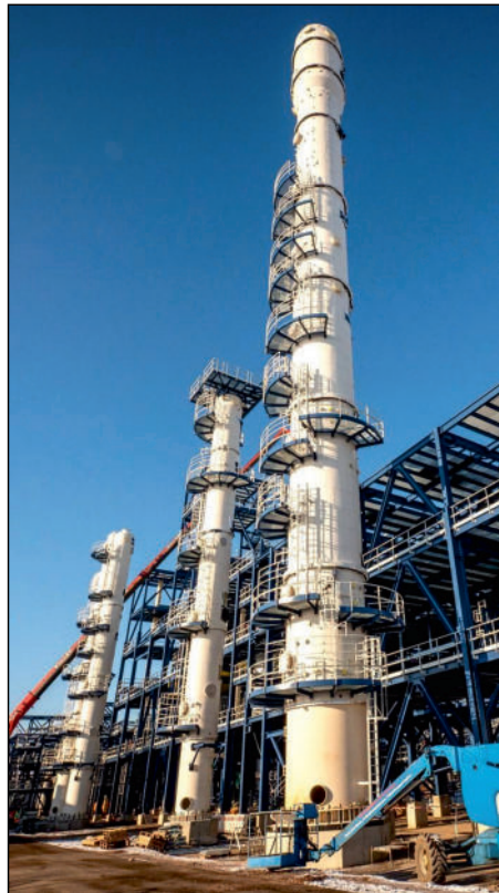
Bild 5 Die Destillationskolonnen der UPM-Bioraffinerie Leuna (rechts vorn die 64 m hohe Destillationskolonne zur Isolierung des Bio-MEGs, Januar 2023, vgl. Bild 1)
